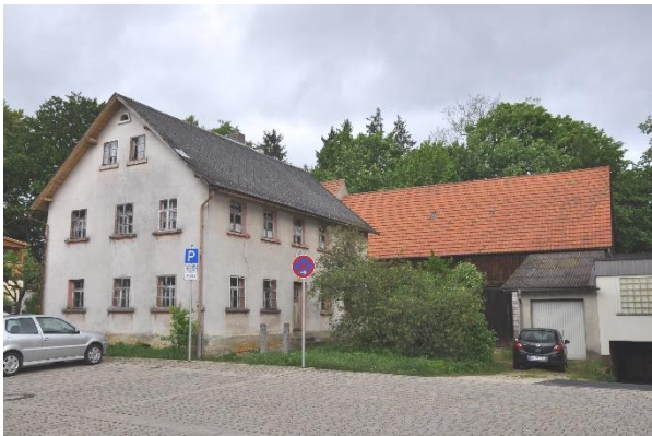
Sanierungsbedarf „Am Anger“
