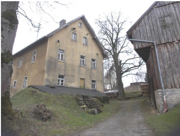
Gebäude mit Sanierungsbedarf in Buchau
