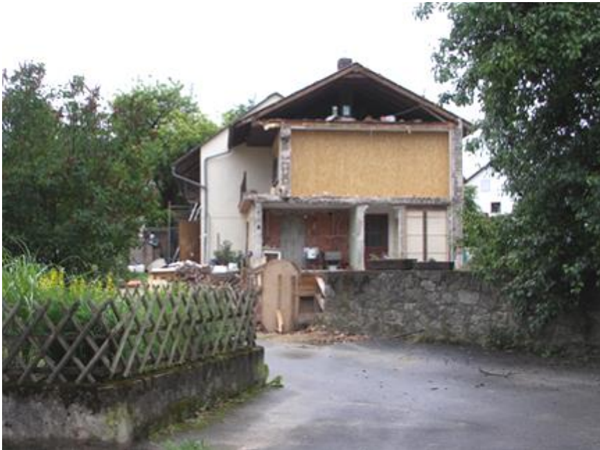
Haus mit Sanierungsbedarf
