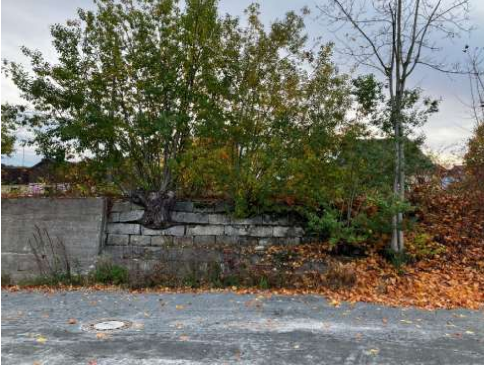
Photo 10: Alte lückige Mauer neben den Bahnanlagen (Photo: Moder, Oktober 2025)
