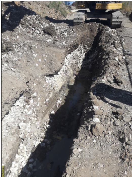
Bild 8: Öffnung des Kanalgrabens in nördliche Richtung am 03.08.2022, Entnahme der Probe „Kanalwasser“, Blickrichtung Nord
