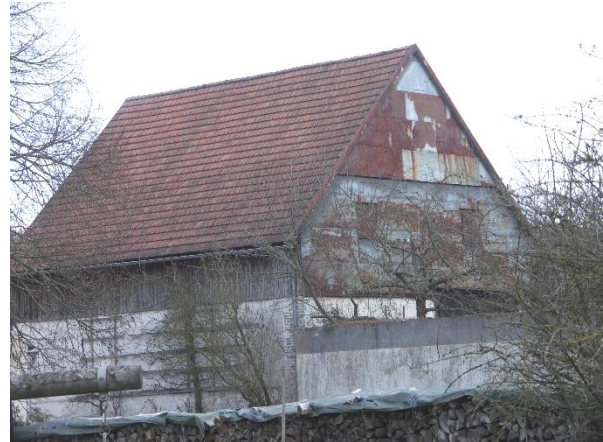
Sanierungsbedarf bei Nebengebäuden
